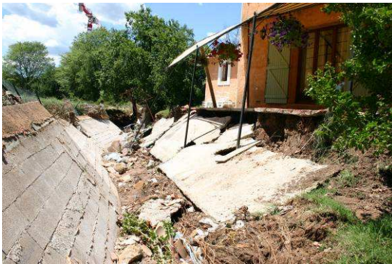
Photos 4 : Le « Vallon » de Vidauban (versant de la colline de Garduère) - Mur de clôture le long du vallon effondré
