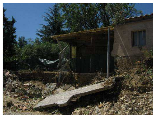
Photos 142 : Figanières – La Tuilière – aval quartier Saint Esprit – Post crue
