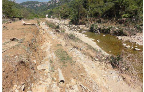
Photos 73 : La Nartuby Chemin des Launes – Post Crue
